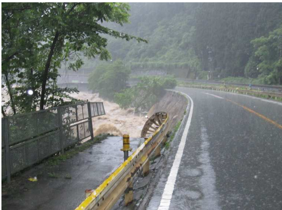
令和2年7月豪雨災害(門坂地内 国道41号線 崩落写真)
