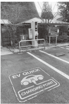
下呂温泉合掌村のEV用充電器
