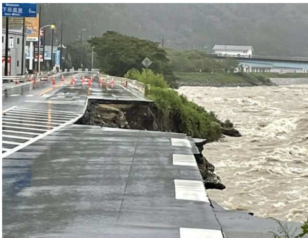
令和3年8月豪雨災害(花池地内 国道41号線 崩落写真)
