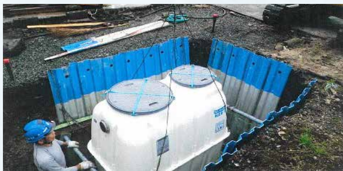
▲合併処理浄化槽
