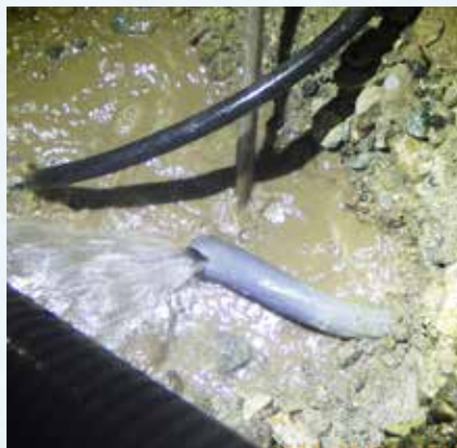
▲水道管破損による漏水
