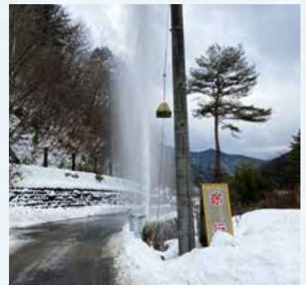
▲空気弁破損による漏水
