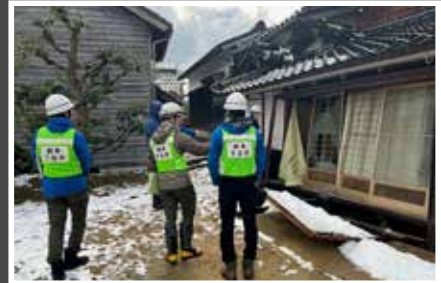
▲宝達志水町の職員と共同して被害家屋の調査を行う市職員
