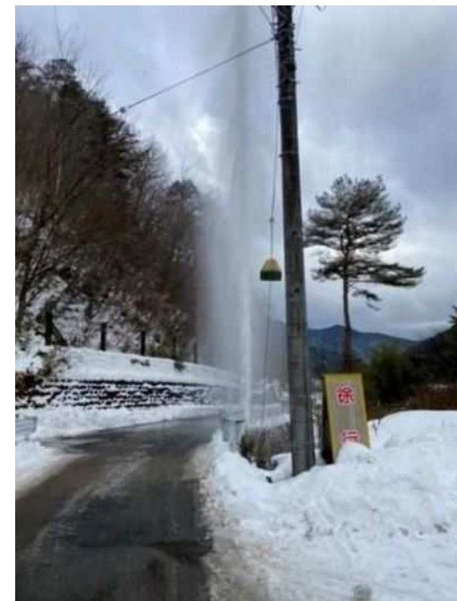
空気弁破損による漏水 (和川地内)
