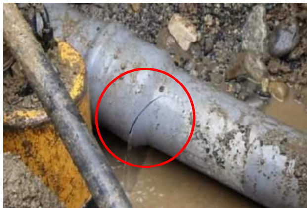
割れた塩ビ管 (萩原町古関地内)
