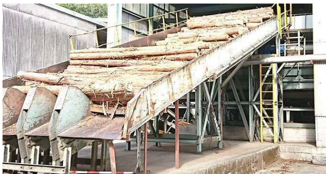
①原料（C・D材）の投入口
