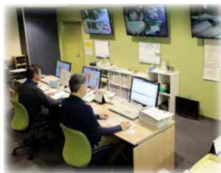
▲ 24 時間体制で管理する中央制御室
