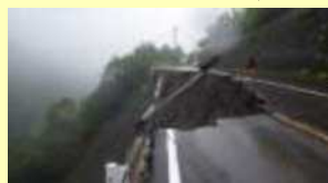
③路側崩壊 (高山市・乗鞍公園線)
