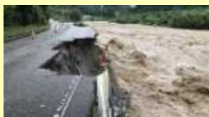
①路側崩壊 (高山市・国道471号)
