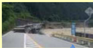
⑦道路崩壊 (下呂市・国道41号)
