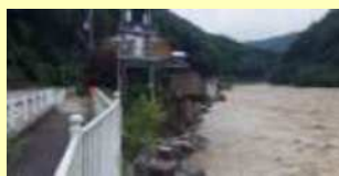
⑤護岸崩壊 (下呂市・飛驒川)
