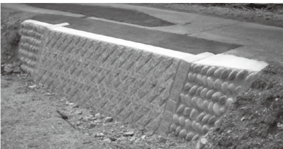
◀災害復旧工事を実施した豪雨災害で被災した道路Ⅱ門和佐
