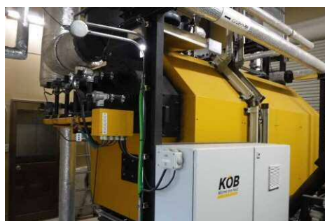
ペレットボイラー
