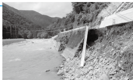
平成 26 年 8 月豪雨の被害
